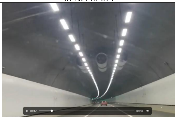
隧道内射流风机
